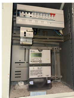
Sikringsskap med automatsikringer.
