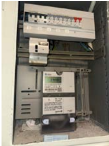
Sikringsskap med automatsikringer.
