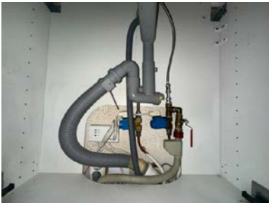
Rørappleg i kjøkkenbenk med Waterguard
