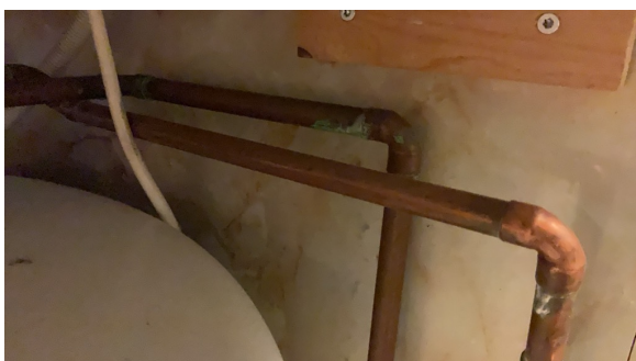
Det er irr på rør.
