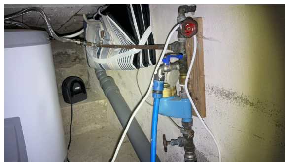
Stoppekran er plassert i krypkjeller.
