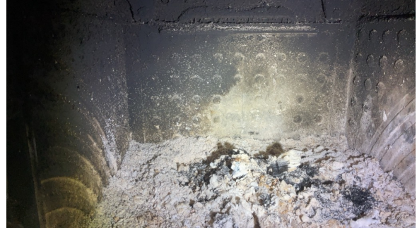
Sprekk i ildfast stein.
