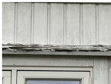
Det er ikke montert vannbrettbeslag på vinduer.
