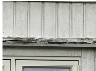
Det er ikke montert vannbrettbeslag på vinduer.
