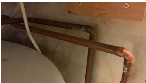
Det er irr på rør.
