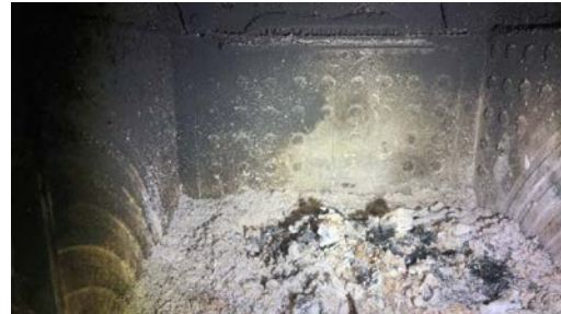
Sprekk i ildfast stein.
