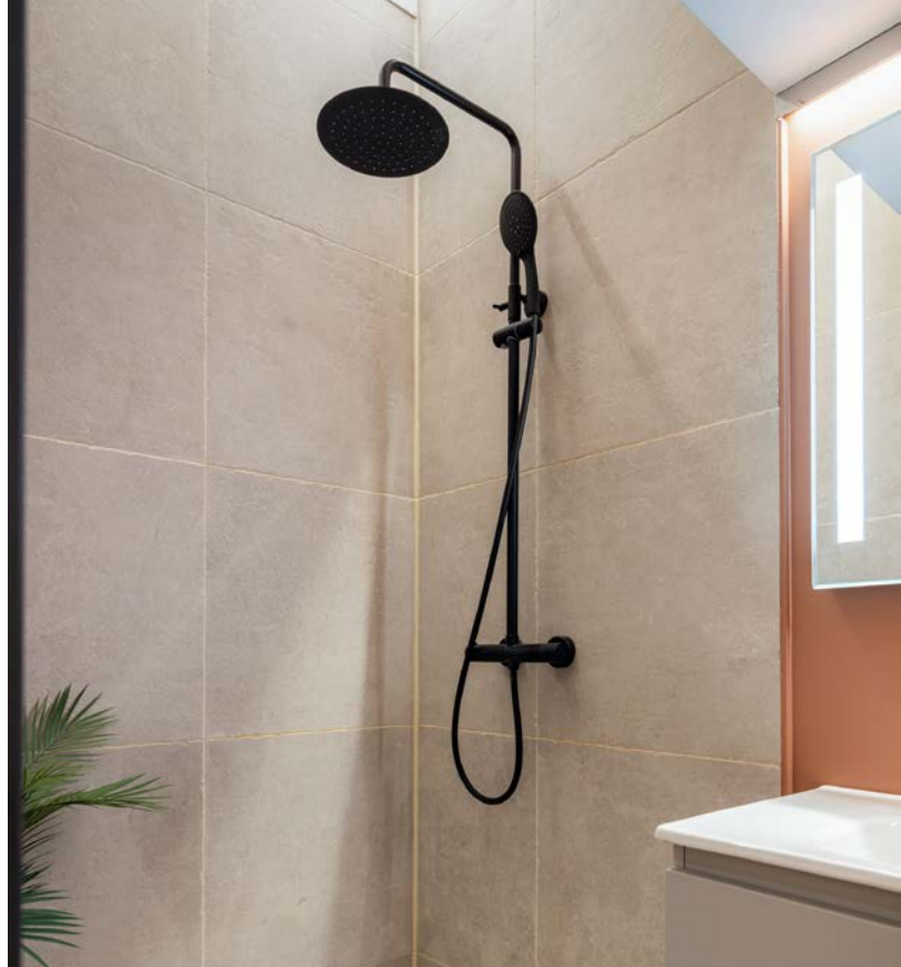
Badet er utstyrt med toalett, dusjhjørne, servant og speil.
