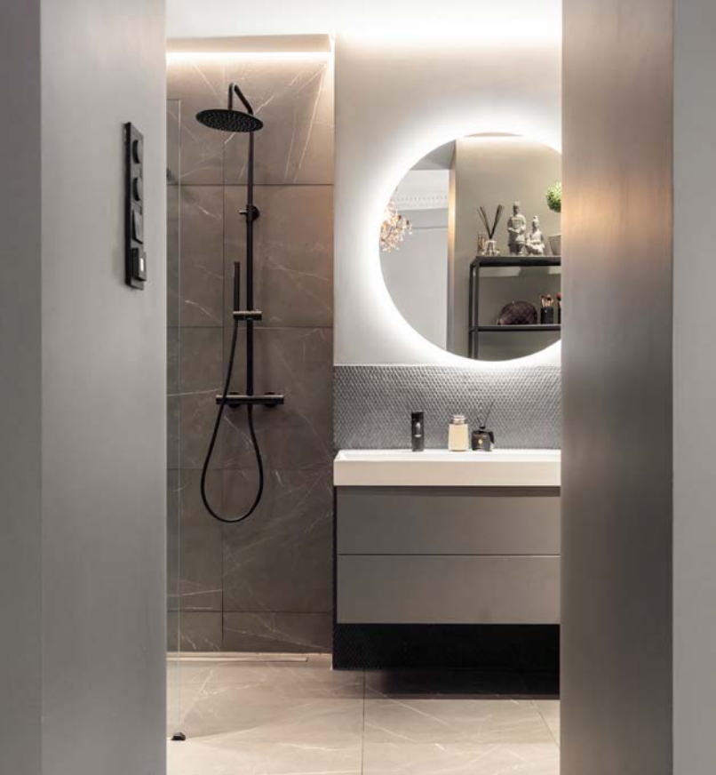
Badet ble oppgradert i 2019 og er innredet for par. Her har du dobbel dusj og servant med dobbel armatur.
