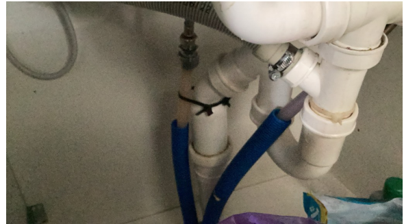
Manglende tettemuffer under vask på kjøkken.
