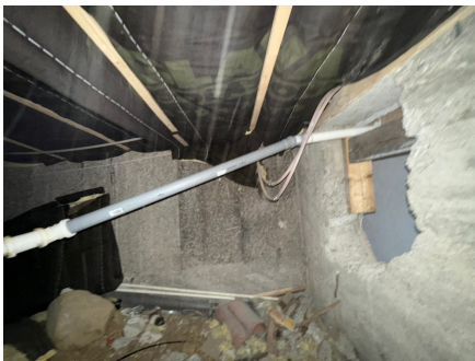
Uisolerte vannrør i krypkjeller.
