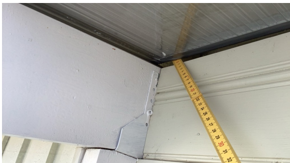
Glippe mellom vegg og takplate
