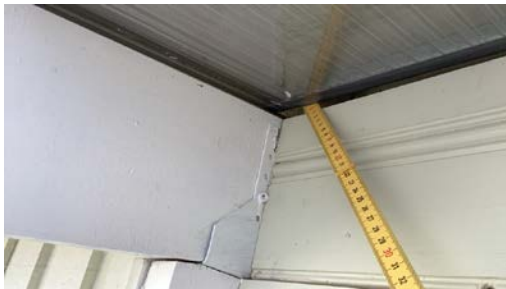
Glippe mellom vegg og takplate
