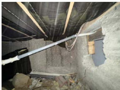
Uisolerte vannrør i krypkjeller.
