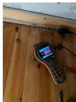
Det er registrert fukt i oppført gulv på bod
