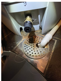
erker etter fukt under varmtvannsbereder
