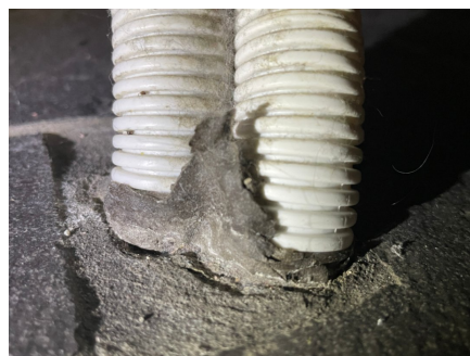
Noe synlig membran under servant, men avluttet for lavt
