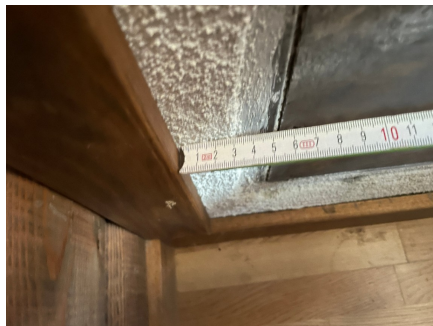
Sotluke for nærme brennbart, og ingen ubrennbar plate på gulv under sotluke
