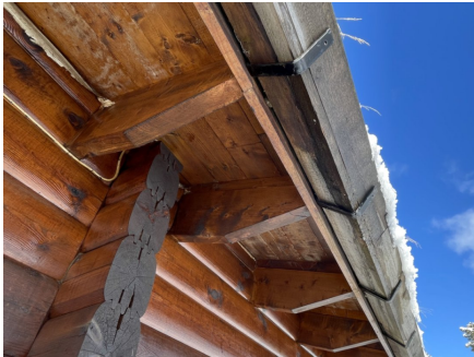
Merker etter fukt og fukt i trevirke i takrenner
