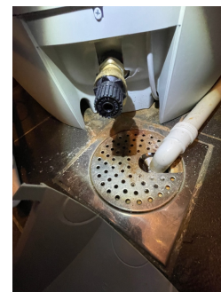
Merker etter fukt på gulv under sikkerhetsventil
