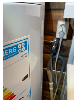
Varmtvannsbereder tilkoblet via stikkontakt
