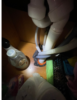
Ikke montert endepugger på vannrør.
