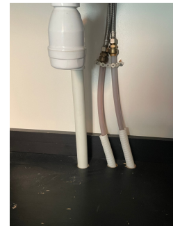
Ikke montert endepugger på vannrør.
