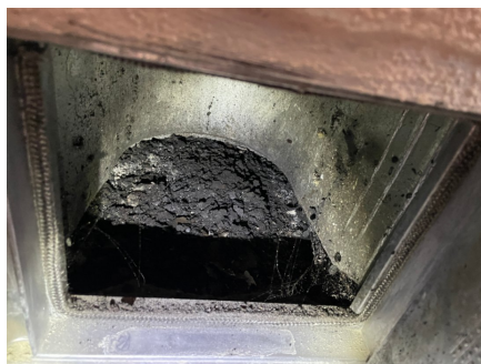
Ikke støpt bunn i sotluke
