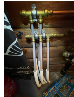
Ingen lekkasjesikring for vannrør
