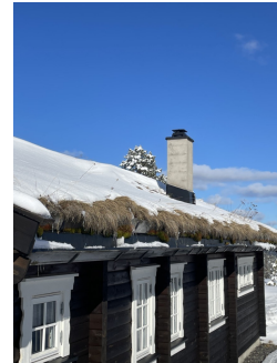
Merker etter fukt og fukt i trevirke i takrenner
