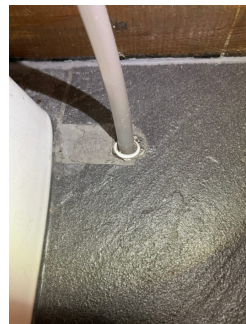
Ingen membran ved rørgjennomføring til toalett
