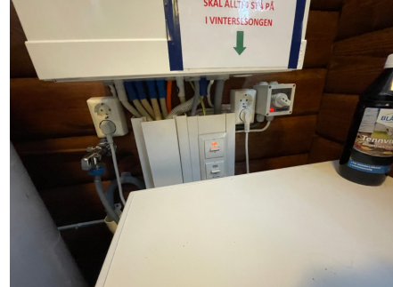
Vanninntak med varmekabel
