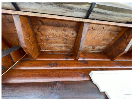
Fuktskader på undersiden av undertak og ingen lufting
