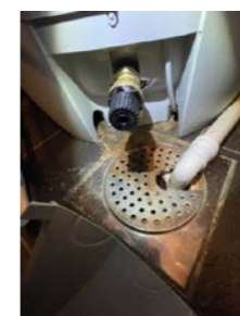
Merker etter fukt under varmtvannsbereider
