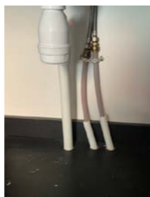
Ikke montert endeplugg på vannrør.
