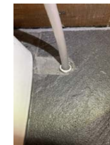
Ingen membran ved rørgjennomføring til toalett
