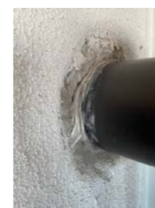
Røykrørsinnføring ved røykrør
