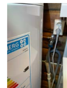
Varmtvannsbereider tilkoblet via stikkontakt
