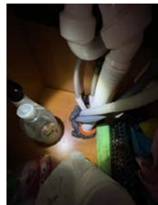
Ikke montert endeplugg på vannrør.
