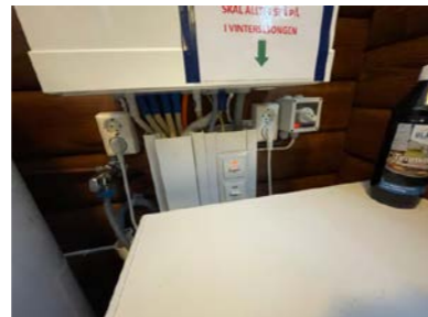
Vanninntak med varmekabel
