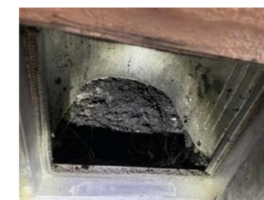
Ikke støpt bunn i sotluke
