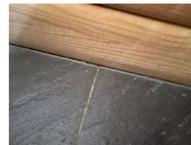
Ingen membran i overgang vegg/gulv
