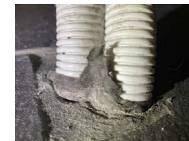
Noe synlig membran under servant, men avsluttet for lavt
