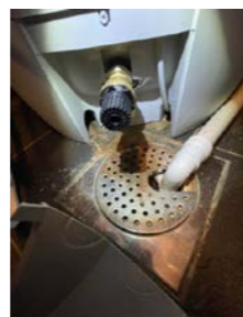
Merker etter fukt på gulv under sikkerhetsventil
