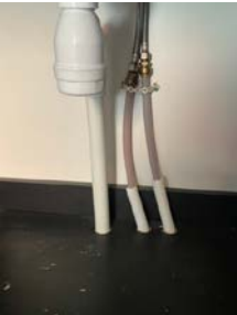
Ikke montert endeplugger på vannrør.
