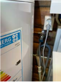
Varmtvannbereder tilkoblet via stikkontakt
