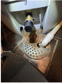
erker etter fukt under varmtvannsbereder
