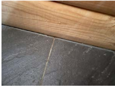
Ingen membran i overgang vegg/gulv
