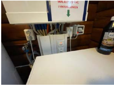
Vanninntak med varmekabel
