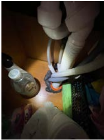
Ikke montert endeplugger på vannrør.
