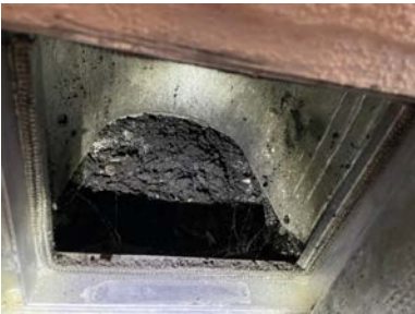
Ikke støpt bunn i sotluke
