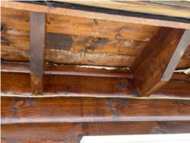
Fukskader på undersiden av undertak og ingen lufting
