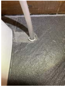
Ingen membran ved rørgjennomføring til toalett
