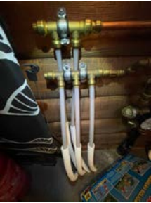
Ingen lekkasjesikring for vannrør
