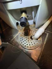
Merker etter fukt på gulv under sikkerhetsventil
