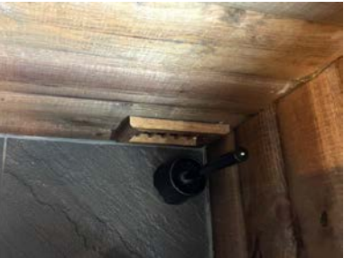
Ventiler føres til baderom
