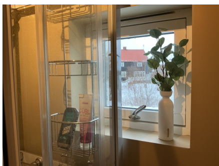
Vindu er plassert i dusjsone.
