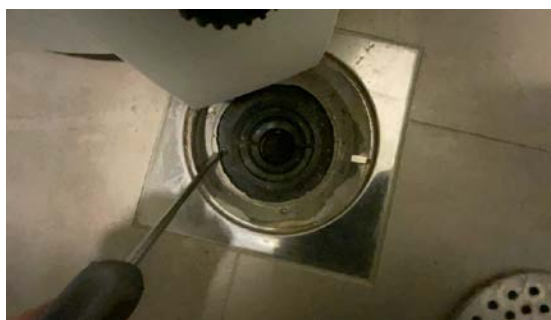
Plastsluk i gulv.
