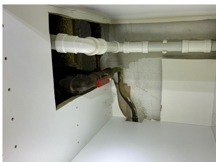
Hovedstoppekran står i seksjon på kjøkken.
