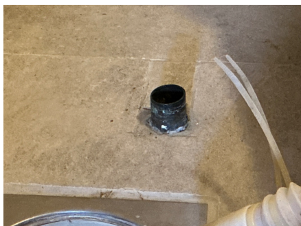
Det registreres kloakklukt fra rør under dusjkabinett.
