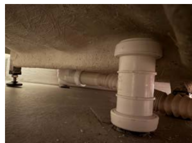
Avløpsrør fra tidligere badekar under dusj-kabinett
