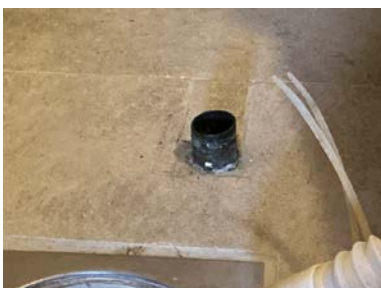
Det registreres kloakklukt fra rør under dusjkabinett.
