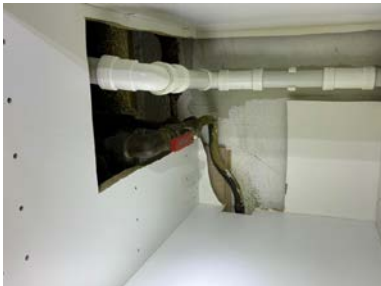
Hovedstoppekran står i seksjon på kjøkken.
