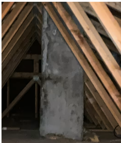
Innvendig pipe på kaldtloft er ispisert fra loftsluke. Det registreres synlige rennemerker på pipen.
