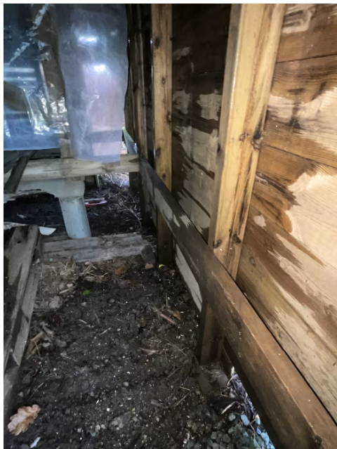
Trekonstruksjoner uten fundamentering og i kontakt med grunn.
