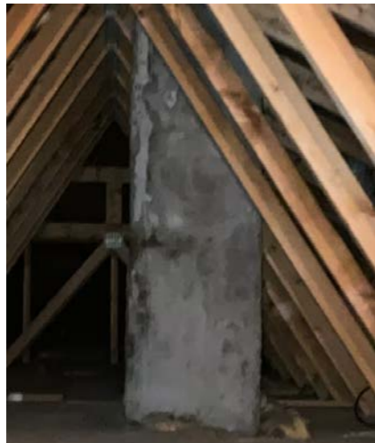
Innvendig pipe på kaldtloft er isisert fra loftsluke. Det registreres synlige rennemerker på pipen.
