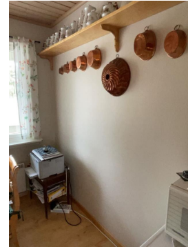
Pipeside tildekket med plate ved kjøkken
