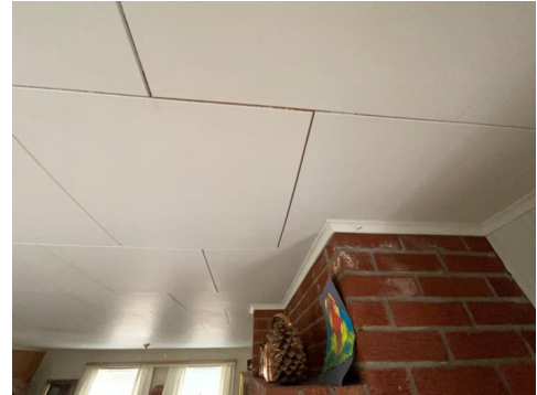
Vært en tidl. lekkasje
