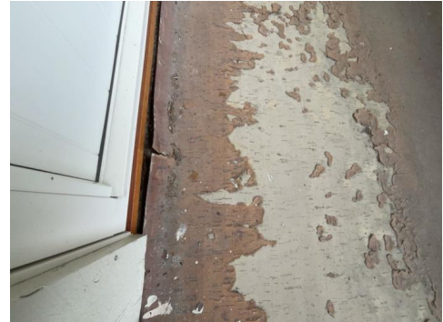
Spukket ved vegg og svært slitt belegg/membran på gulvet av balkong
