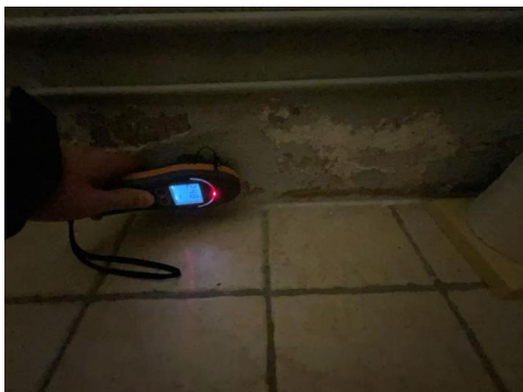
Saltutslag nedkant vegg
