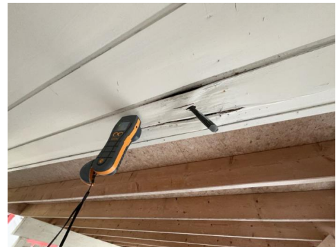
Råte under balkong.
