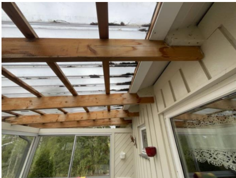
Skjolder på sperre ved overgang hustak
