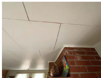
Vært en tidl. lekkasje
