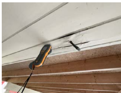
Råte under balkong.
