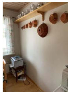
Pipeside tildekket med plate ved kjøkken
