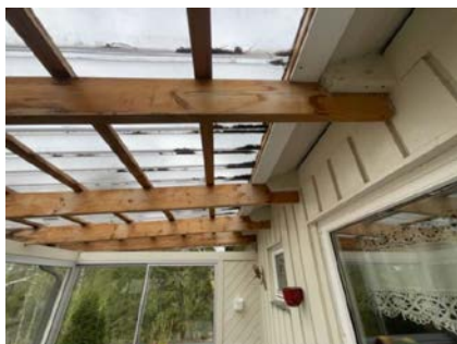
Skjolder på sperre ved overgang hustak
