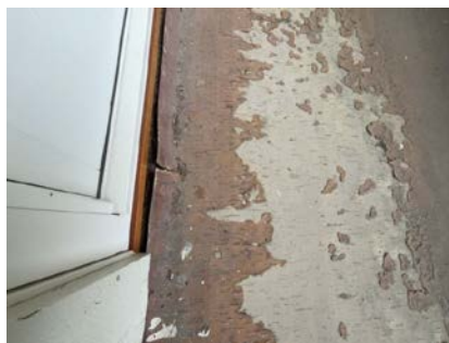
Sprukket ved vegg og svært slitt belegg/membran på gulvet av balkong
