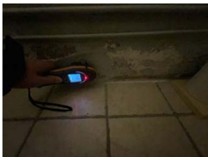
Saltutslag nedkant vegg
