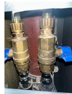
Stoppekraner plassert i luke på bad
