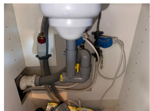
Røropplegg i kjøkkenbenk med Waterguard
