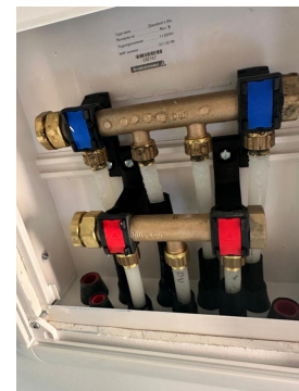
Samleskap med rørkurser på bad
