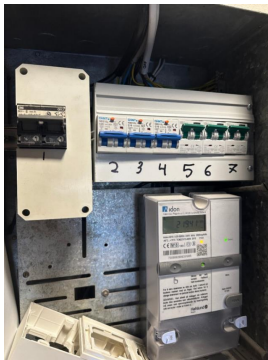
Sikringsskap med automatsikringer.
