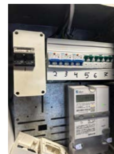
Sikringsskap med automatsikringer.
