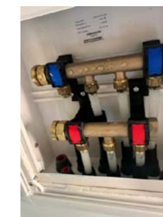
Samleskap med rørkurser på bad
