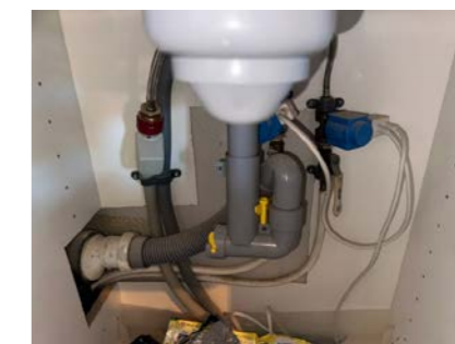
Røropplegg i kjøkkenbenk med Waterguard
