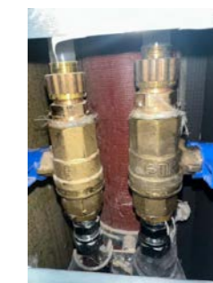
Stoppekraner plassert i luke på bad
