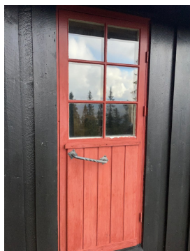
Værslitte flater og karmen på terrassedør
