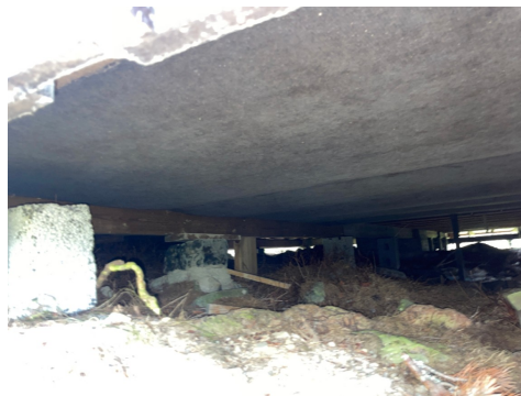
Dårlig terrengfall vekk fra konstruksjoner
