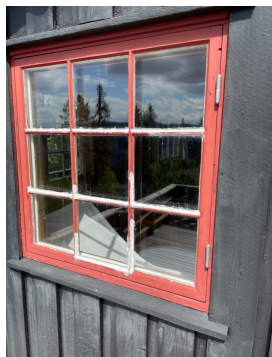
Eksempel på værslitt trevirke/oppsprukket kitt utvendig.
