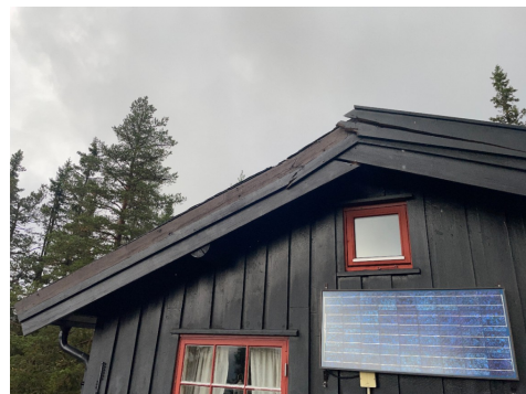
Synlige skader på vindskier.
