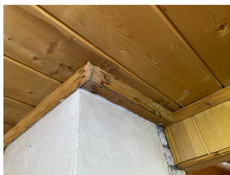
Fuktmerker rundt pipe.
