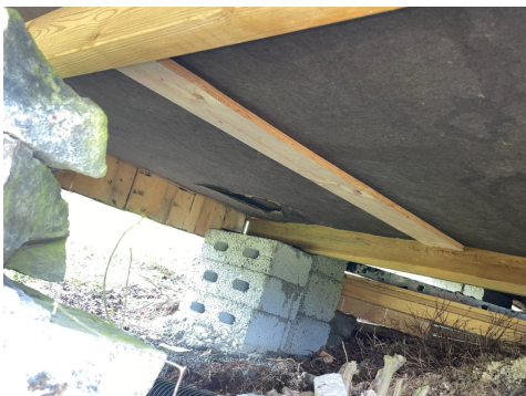
Skade i stubbegulv
