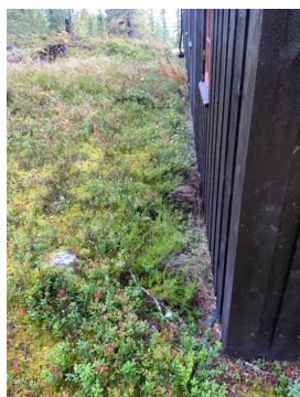
Kledning går stedvis helt ned til terreng.
