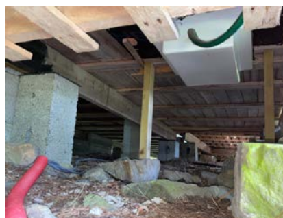
Noe provisorisk understøttelse.
