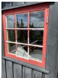
Eksempel på værslitt trevirke/oppsprukket kitt utvendig.
