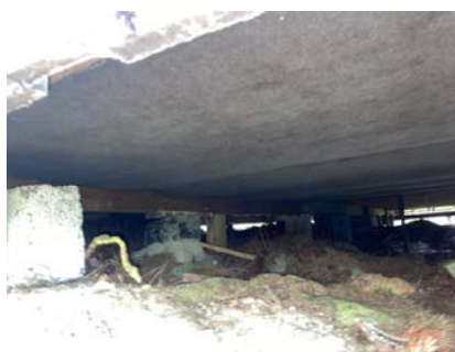
Dårlig terrengfall vekk fra konstruksjoner
