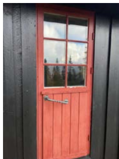
Værslitte flater og karmen på terrassedør
