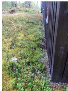
Kledning går stedvis helt ned til terreng.
