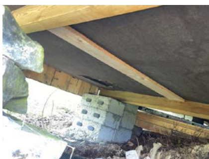
Skade i stubbegulv
