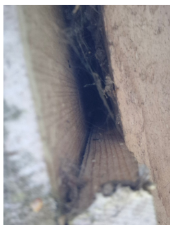
Mangler musesperre bak kledningsbord.
