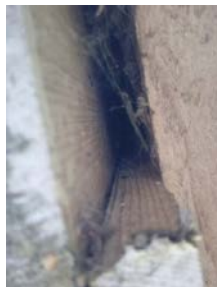
Mangler musesperre bak kledningsbord.
