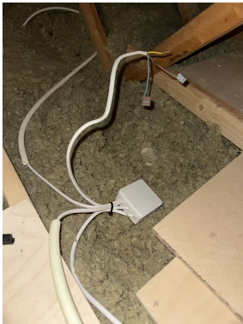
Ledning med wago er ikke forsvarlig avsluttet.
