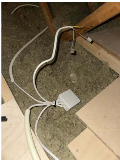
Ledning med wago er ikke forsvarlig avsluttet.
