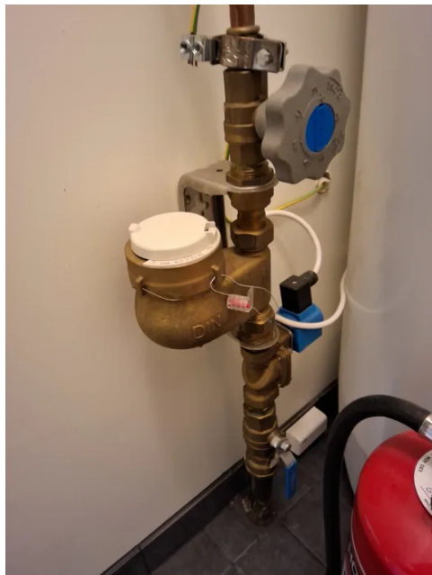
Hovedinntak med stoppekran og automatisk vannstoppeventil.
