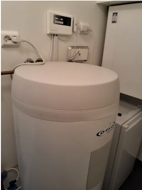
Varmtvannsbereder er plassert på bod/teknisk rom.
