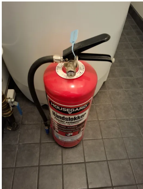
Brannslukningsapparat er plassert på bod/teknisk rom.
