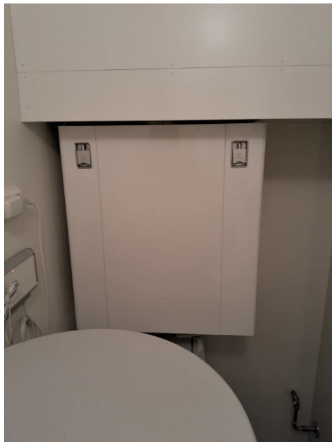
Ventilasjonsaggregat er plassert på bod/teknisk rom.
