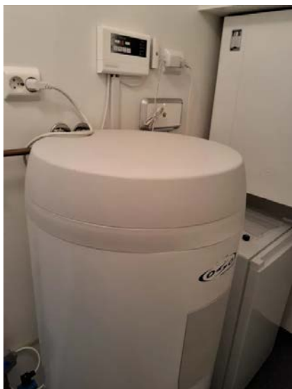
Varmtvannsbereder er plassert på bod/teknisk rom.
