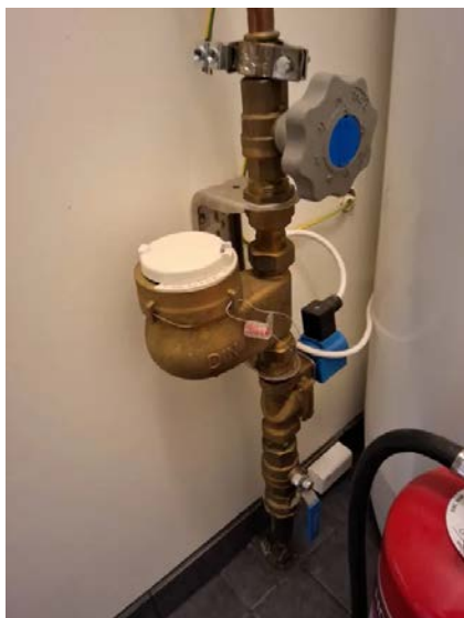
Hovedinntak med stoppekran og automatisk vannstoppeventil.
