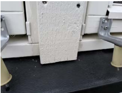
Enkelte karmar har krakelert overflatebehandling.
