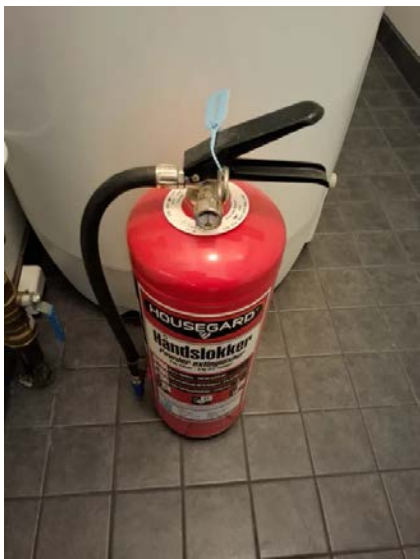
Brannslukningsapparat er plassert på bod/teknisk rom.
