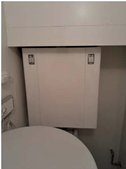
Ventilasjonsaggregat er plassert på bod/teknisk rom.
