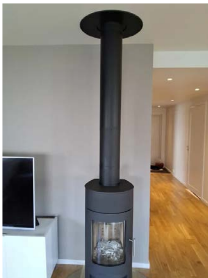
Vedovn med glassdør i stue tilknyttet stålpipe.
