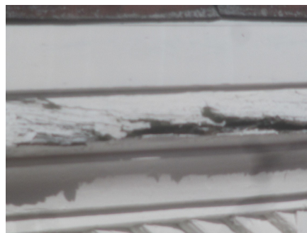
Råteskader på en vindskie.
