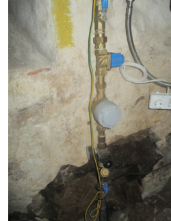
Innvendig stoppekran med vannmåler i grovkjeller
