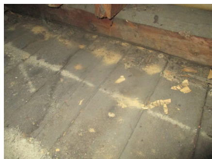
Noe borremel på gulvet enkelte steder.
