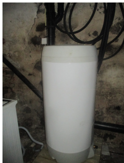
Ny bereder er plassert i grovkjeller
