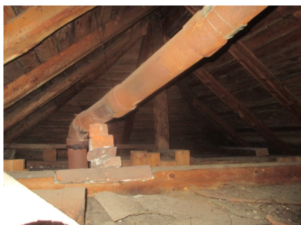
Ingen isolasjon i etasjeskille
