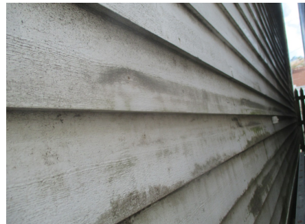
Kledning i mot nabo trenger vedlikehold.
