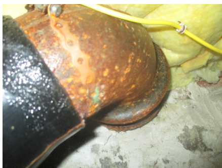
Avløpsrør av støpejern
