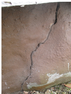
Sprekk i grunnmur i ene ytterhjørne i bakgården.
