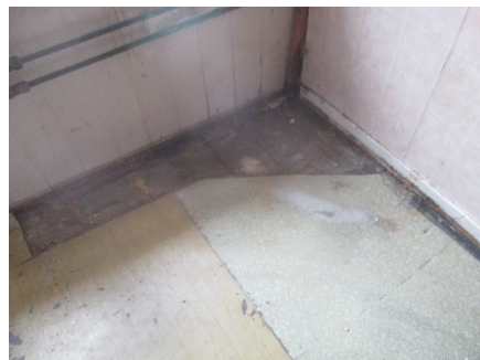
Må fuktsikres på nytt.
