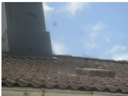
Eldre slitt plater som takteking i mot gate.
