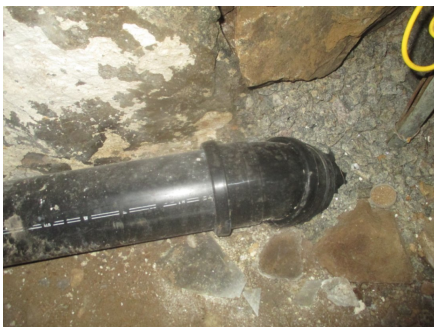
Nyere avløpsrør av plast
