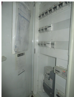
Sikringsskapet er plassert i første etasje.
