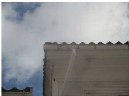
Eldre takrenner med noen skader.
