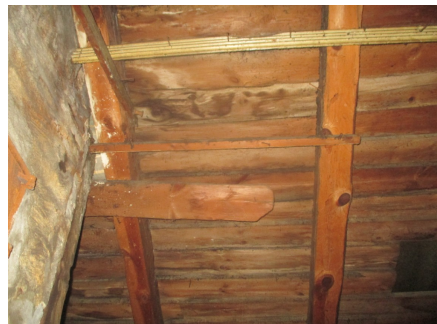
Eldre lekkasje i rundt pipe.
