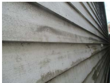
Kledning i mot nabo trenger vedlikehold.
