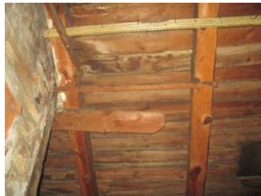
Eldre lekkasje i rundt pipe.
