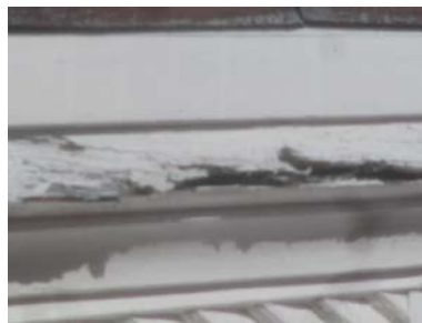
Råteskader på en vindskie.
