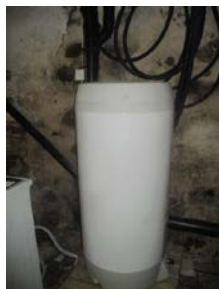
Ny bereder er plassert i grovkjeller
