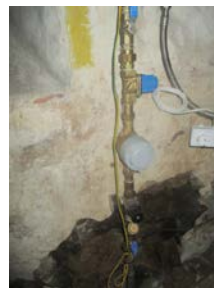
Innvendig stoppekran med vannmåler i grovkjeller
