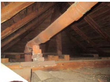
Ingen isolasjon i etasjeskille
