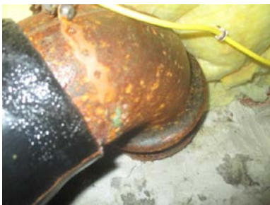
Avløpsrør av støpejern
