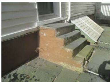
Støpt trapp har siget noe på ene siden.
