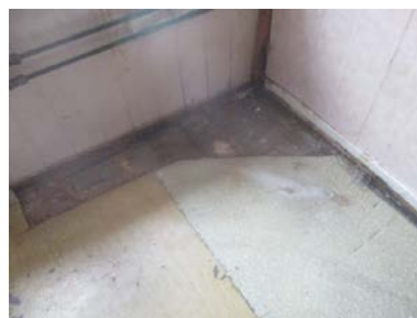
Må fuktsikres på nytt.
