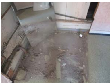
Må bygges opp på nytt.
