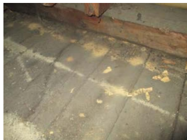
Noe borremel på gulvet enkelte steder.
