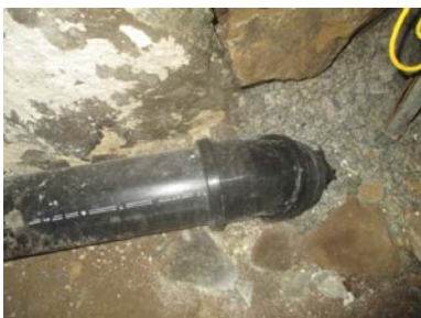
Nyere avløpsrør av plast
