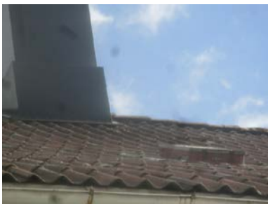
Eldre slitt plater som takteking i mot gate.
