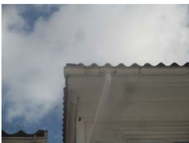
Eldre takrenner med noen skader.
