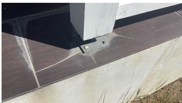
Flere skader på fliser.
