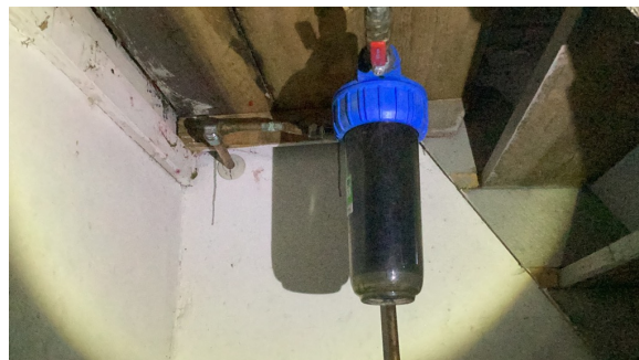
Vannfilter i kjeller.
