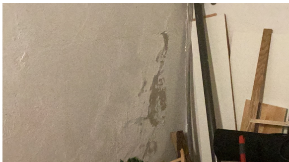
Stedvis avskaling på overflater.
