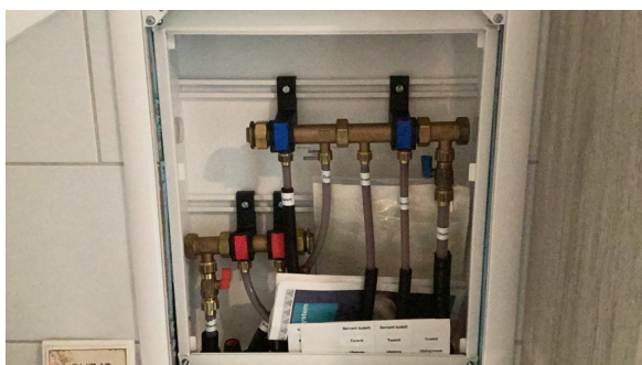
Fordelerskap for vannrør på bad i 2. etasje.
