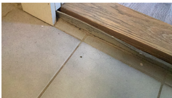
Gulvbelegg stikker opp ved dør.
