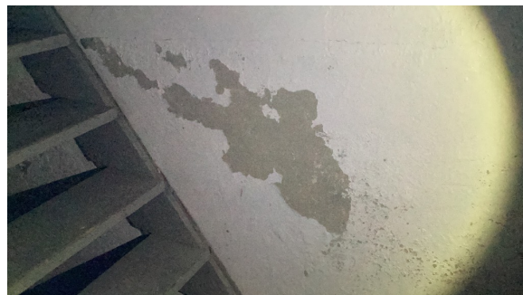
Stedvis avskaling på overflater.
