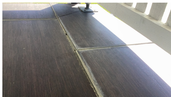
Flere skader på fliser.
