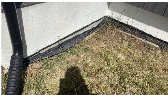
Innfesting av fuktsperre er stedvis løs.
