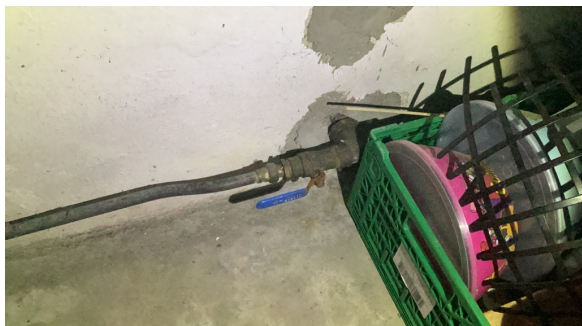
Vanninntak med stoppekran i kjeller.
