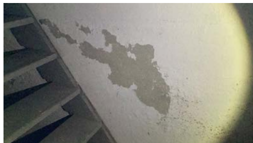
Stedvis avskaling på overflater.
