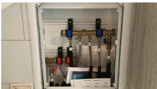
Fordelerskap for vannrør på bad i 2. etasje.
