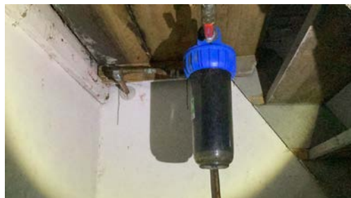
Vannfilter i kjeller.
