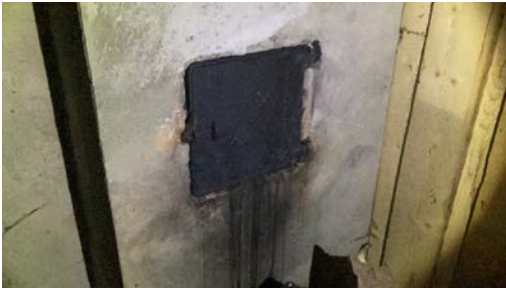
Sotluke i kjeller.
