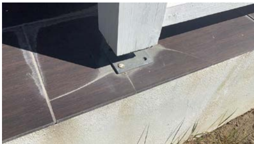
Flere skader på fliser.
