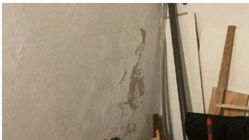
Stedvis avskaling på overflater.
