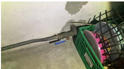
Vanninntak med stoppekran i kjeller.
