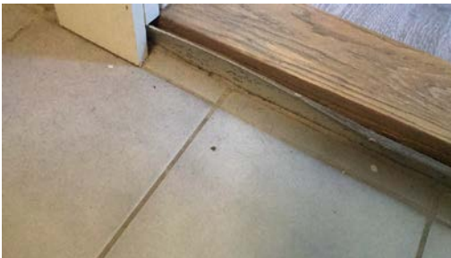
Gulvbelegg stikker opp ved dør.
