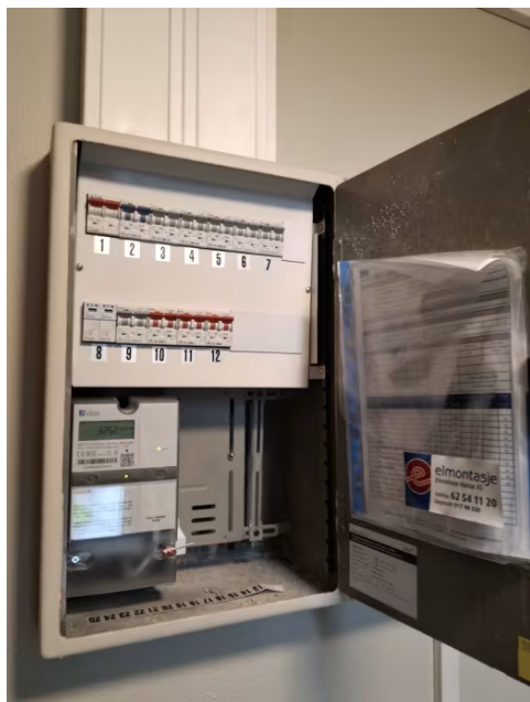
Sikringsskap er plassert i felles trappeoppgang.
