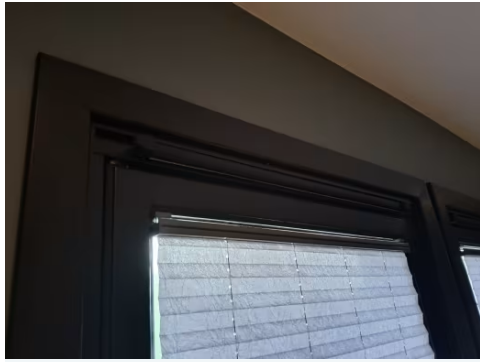
Naturlig ventilasjon med spalteventiler i vinduer.
