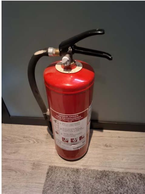
Brannslukningsapparat plassert på soverom.
