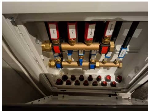
Fordelerskap for rør-i-rør er plassert på bad.
