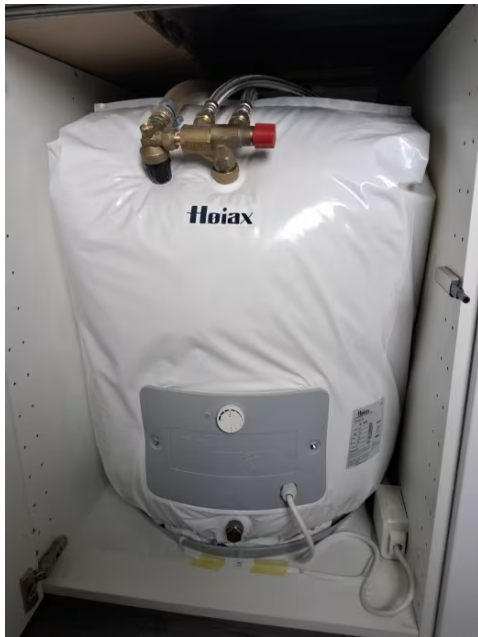
Varmtvannsbereder er plassert i kjøkkeninnredning.
