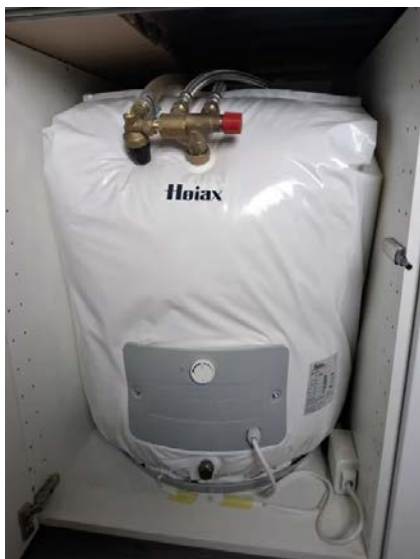
Varmtvannsbereder er plassert i kjøkkeninnredning.
