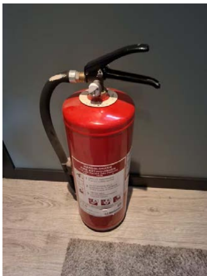
Brannslukningsapparat plassert på soverom.
