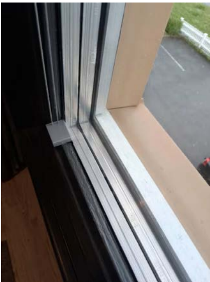
Leiligheten har vinduer med karmen av tre og tre-lags glass.
