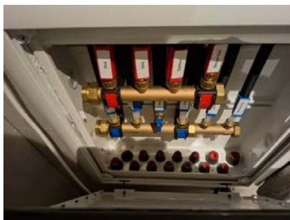
Fordelerskap for rør-i-rør er plassert på bad.
