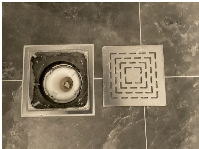
Bilde av sluk
