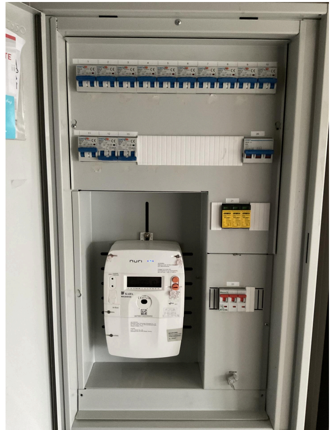
EI-skap med 1.etg med måler og automatsikringer
