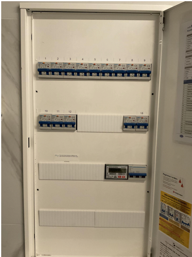
El-skap i u.etg med bi-måler og automatsikringer
