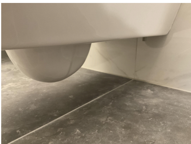
Mangler drenasje fra innebygd sistene
