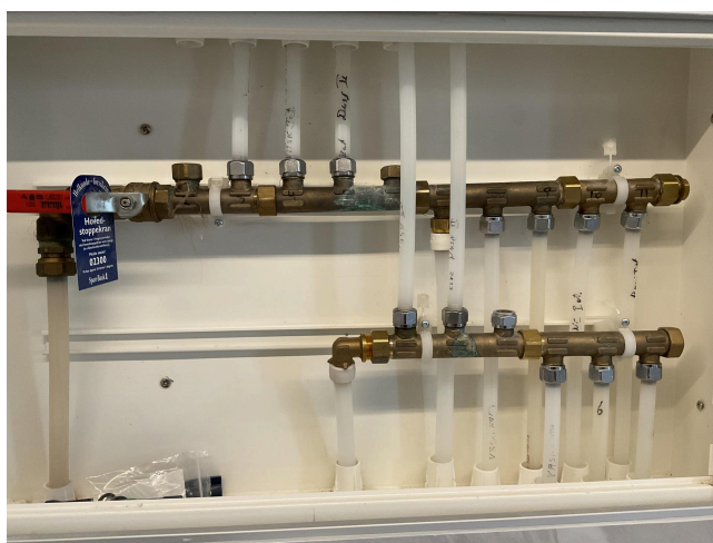
Fordelerskap rør i rør på bad 1.etg
