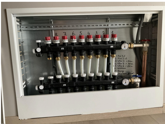
Styring for vannbåren varme i u.etg
