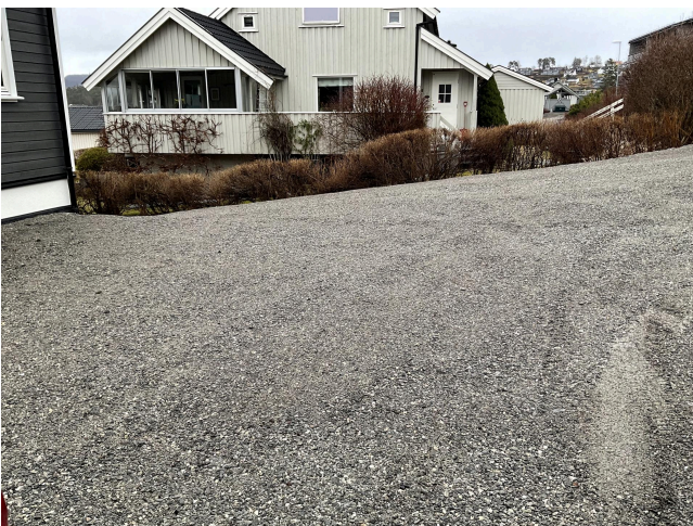
Feil hellingsgrad mot grunnmur
