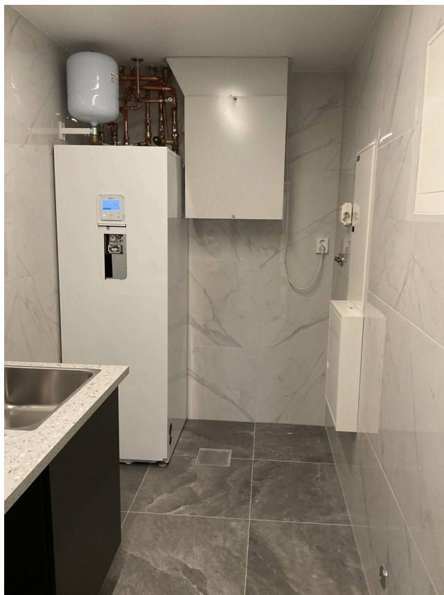
Vannbåren varme plassert på vaskerom/tekn.rom i u.etg
