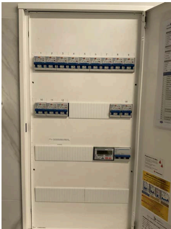
El-skap i u.etg med bi-måler og automatsikringer
