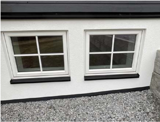
Synlig fuksikring rundt bolig
