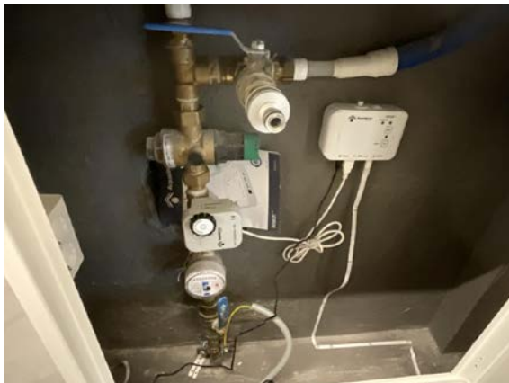
Bilde fra inspeksjonsluke i bad u.etg. Stoppekrane, vannmåler, vannvarsler/lekkasjestopper
