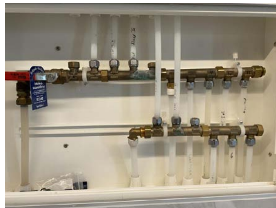
Fordelerskap rør i rør på bad 1.etg
