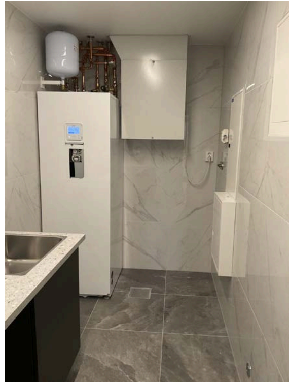
Vannbåren varme plassert på vaskerom/tekn.rom i u.etg
