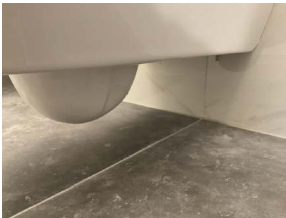
Mangler drenasje fra innebygd sistene
