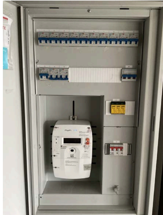
El-skap med 1.etg med måler og automatsikringer
