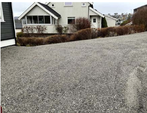
Feil hellingsgrad mot grunnmur
