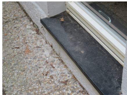
Feil utførelse på beslag under kjellervinduer.
