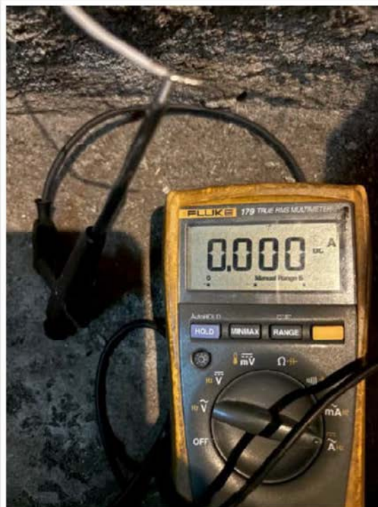
Elektroder Yttervegg vest, er "brent opp" ingen strøm ut til denne vegger
