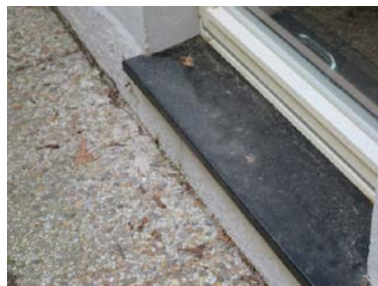
Feil utførelse på beslag under kjellervinduer.
