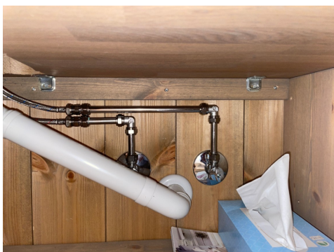
Utette rørgjennomføringer i våtsone
