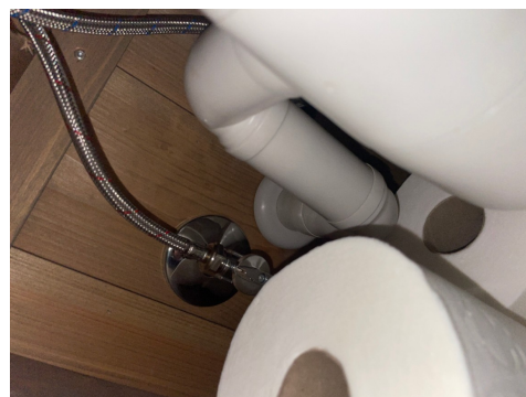
Utette rørgjennomføringer i våtsone
