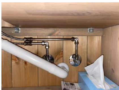
Utette rørgjennomføringer i våtsone
