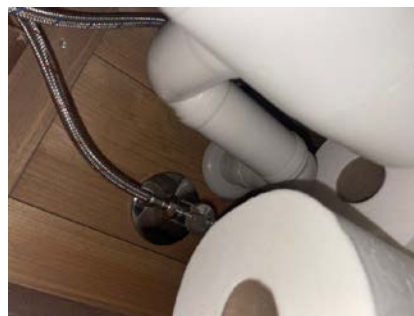
Utette rørgjennomføringer i våtsone
