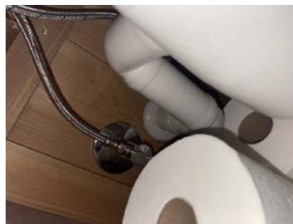
Utette rørgjennomføringer i våtsone
