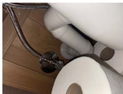
Utette rørgjennomføringer i våtsone
