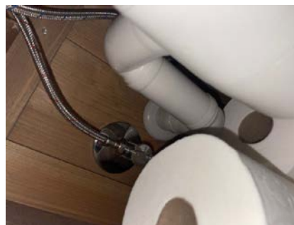
Utette rørgjennomføringer i våtsone
