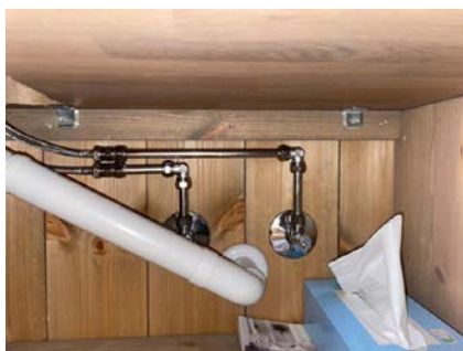
Utette rørgjennomføringer i våtsone
