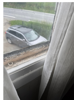
Muggsopp i overflater av vinduer
