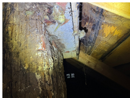
Fuktmerker i undertak ved pipe
