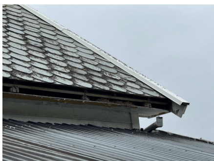
Dekkbord og takrenne har løsnet fra takfot
