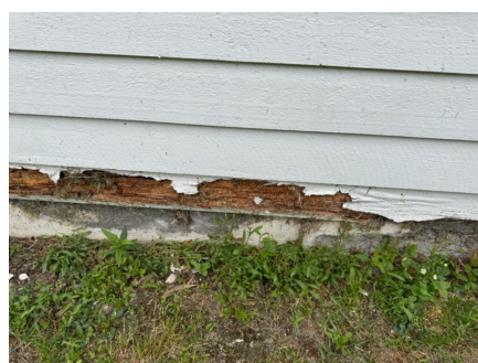
Råteskader i panel
