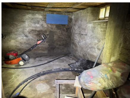
Fuktig grunnmur og kjellergulv
