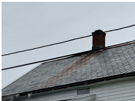
Dekkbord og takrenne har løsnet fra takfot
