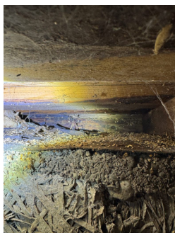
Mulig påbegynnende råte i bunnsvill
