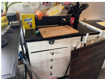
Slitasje i kjøkkeninnredning
