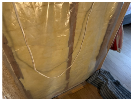
Uferdige arbeider med overflater
