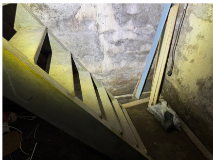
Trapp uten rekkverk til kjeller
