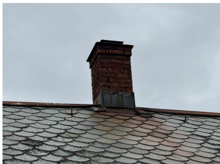
Forvitring av fuger på pipe
