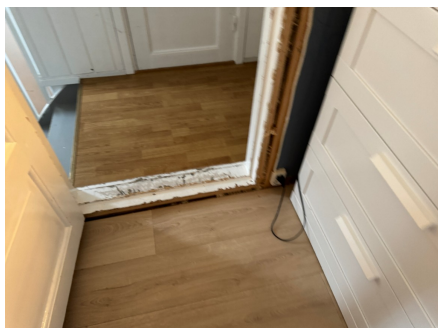
Uferdige arbeider med overflater
