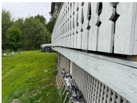
Skjevheter i veranda
