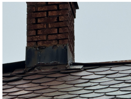
Slitt beslag på pipe
