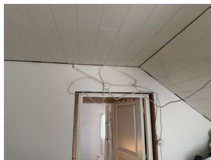
Løse ledninger og el. punkter
