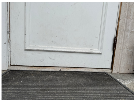
Ikke montert beslag under dør
