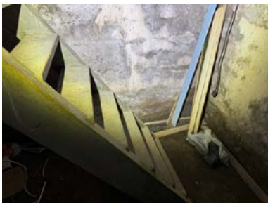
Trapp uten rekkverk til kjeller
