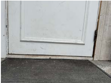
Ikke montert beslag under dør
