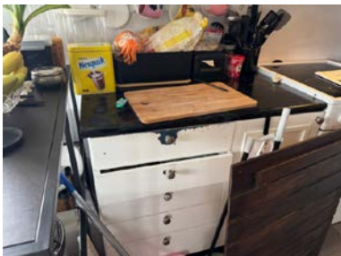
Slitasje i kjøkkeninnredning
