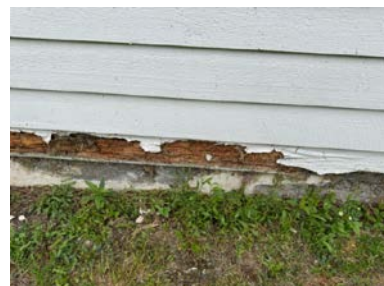
Råteskader i panel
