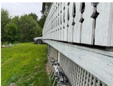
Skjevheter i veranda
