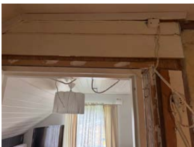
Løse ledninger og kontakter
