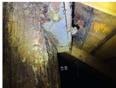
Fuktmerker i undertak ved pipe
