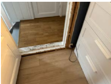
Uferdige arbeider med overflater
