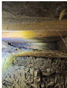
Mulig påbegynnende råte i bunnsvill
