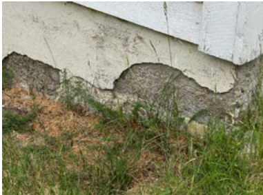
Avflassing på grunnmur
