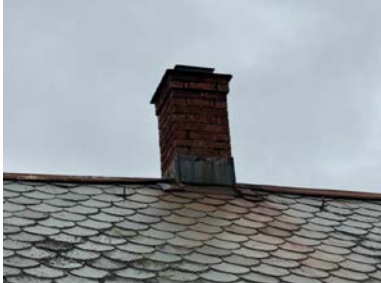
Forvitring av fuger på pipe
