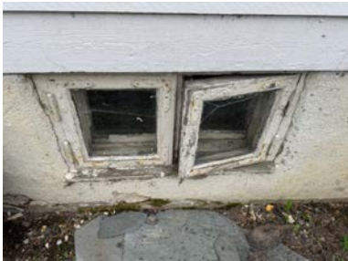
Sprekt glass i kjellervinduer
