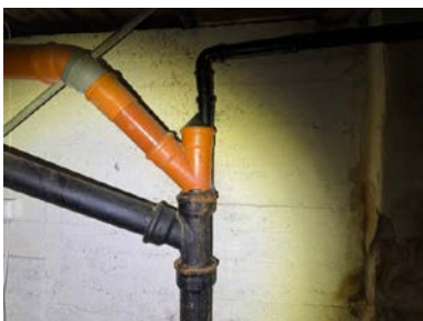
Avløpsrør av støpejern og plast
