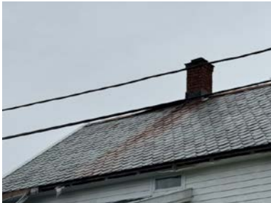
Dekkbord og takrenne har løsnet fra takfot
