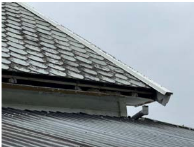
Dekkbord og takrenne har løsnet fra takfot
