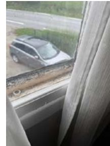
Muggsopp i overflater av vinduer
