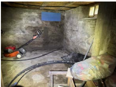
Fuktig grunnmur og kjellergulv
