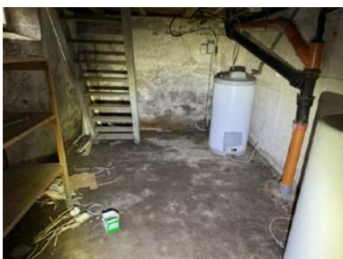
Fuktig grunnmur og kjellergulv
