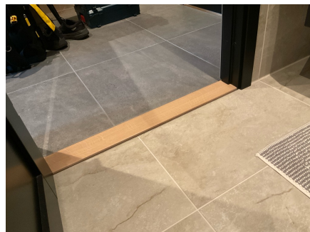
Fallforhold utenfor dusjsone er mindre enn krav.
