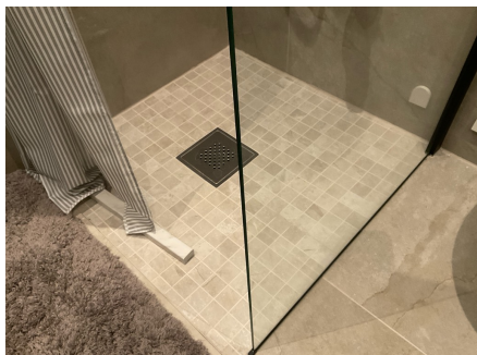
Tilstrekkelig fall mot sluk i nedsenket dusjsone.
