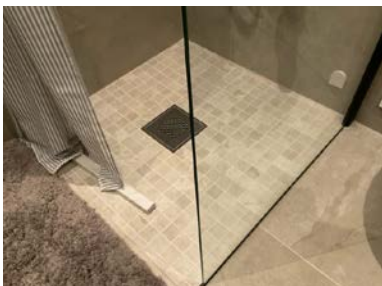
Tilstrekkelig fall mot sluk i nedsenket dusjsone.
