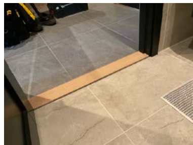
Fallforhold utenfor dusjsone er mindre enn krav.
